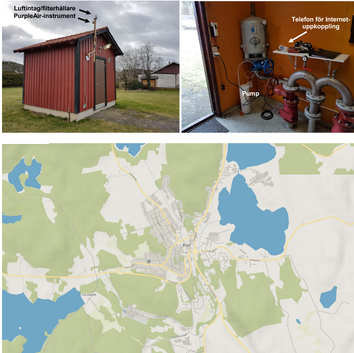
Figur 1. Mätplatsen vid Långgatan i Kisa. Utrustningen monterades på ett pumphus varifrån el kunde tas. Överst till höger ses luftpumpen som placerades inne i pumphuset. Via en slang kopplades sedan pumpen till en filterhållare som monterades på en regel som stack upp ovanför pumphusets tak. Partikelmätaren monterades just under filterhållaren. På kartan är mätplatsen markerad med en grå punkt väster om Kisa centrum.
